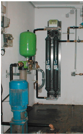
Abbildung 1: Kleinanlage zur Versorgung einer Pferdezucht
